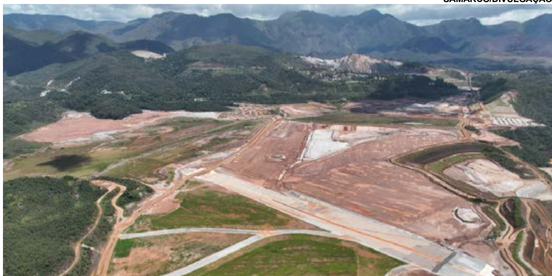
AS OBRAS DE descaracterização da barragem do Germano estão avançadas, com 75% das intervenções concluídas
